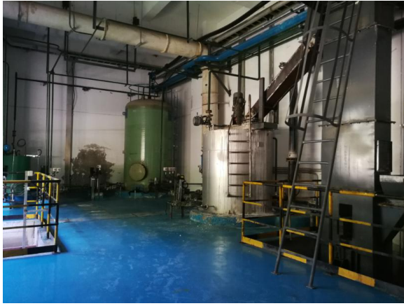
SNCR脱硝车间
