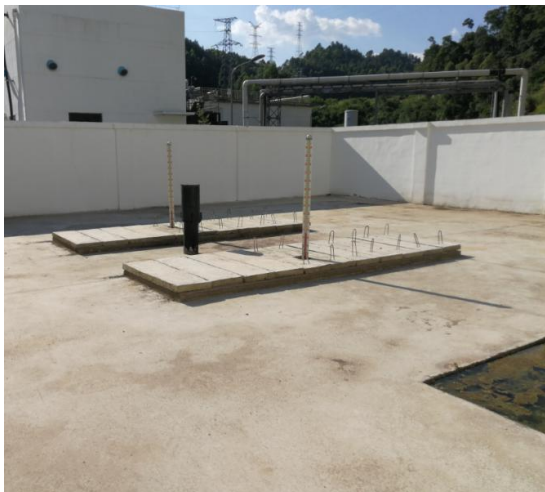
地埋式柴油罐
