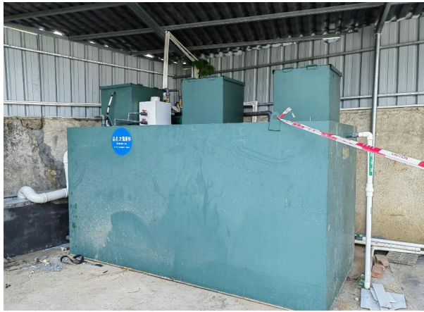
废水处理设施
