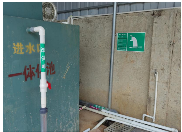
废水排放口标识
