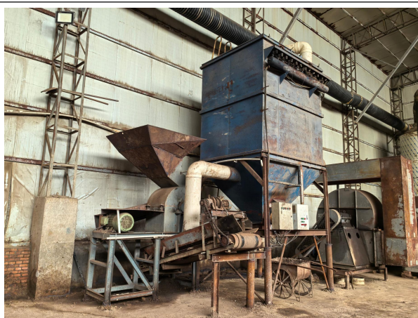
破碎机及布袋除尘器
